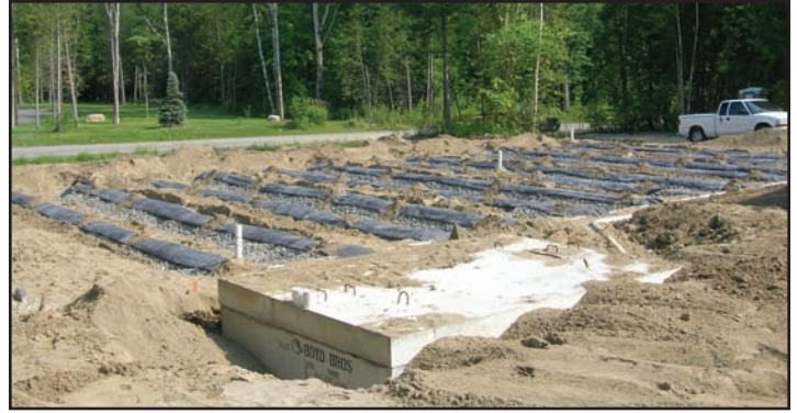
Fosse septique et champ d'épuration
