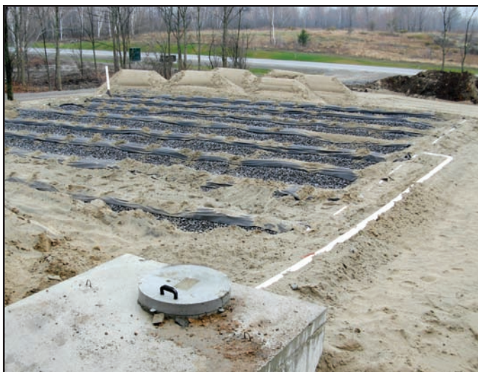
Champ d'épuration avec tuyaux perforés en PVC
